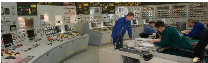
Блочный щит управления АЭС
