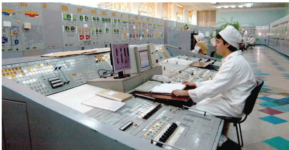
Центральный пульт управления переработкой ОЯТ
