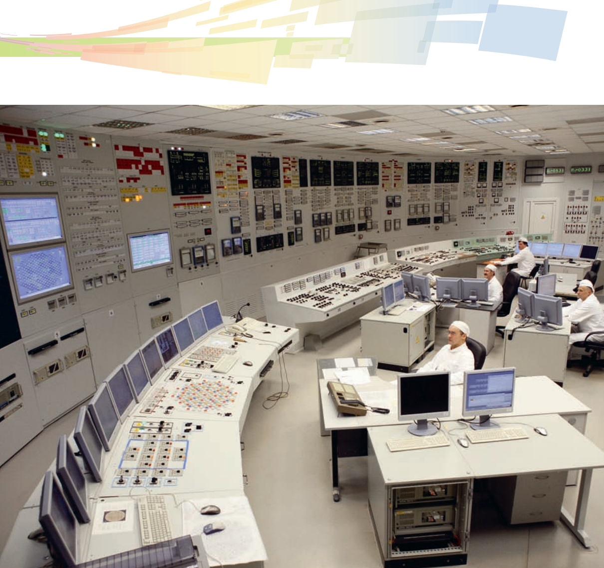
Щит управления энергоблоком Ленинградской АЭС
