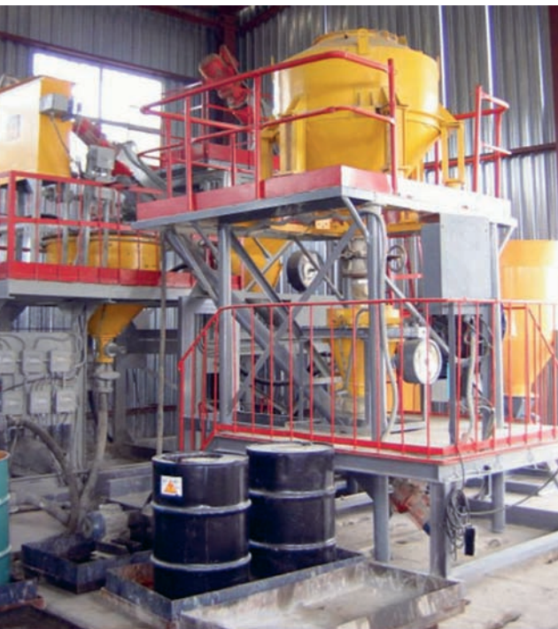
Установка для цементирования жидких радиоактивных отходов
